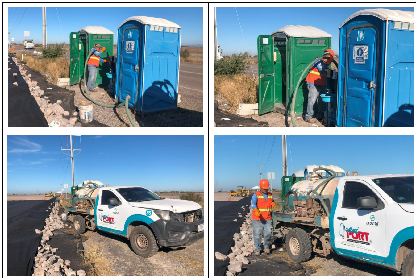
Figura 28. Recolección y traslado de aguas residuales.
