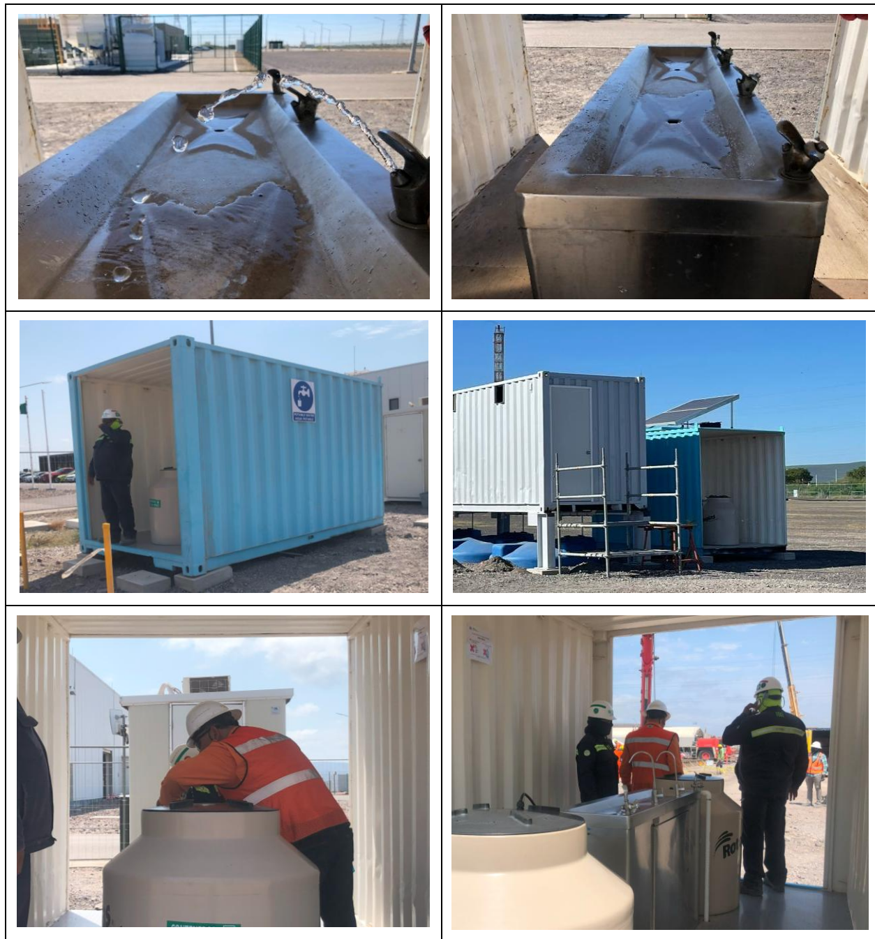
Figura 13. Suministro de agua potable.
